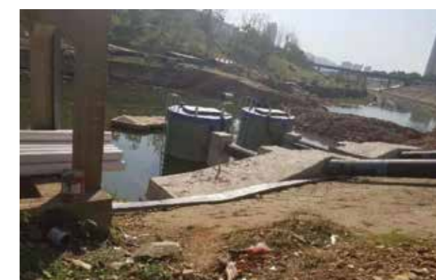
景德镇泵站 日处理量：7680m 3 /D 泵站规格：DN3000*5900
