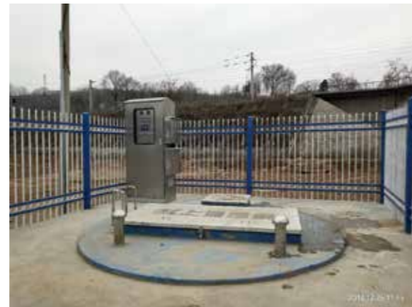
陕西汉中排水泵站 泵站日排水量：86400m 3 /D 泵站规格：DN3800*7600
