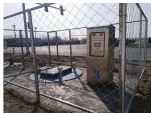
北京青云店泵站
