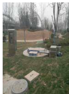
邓州小区泵站，配套等离子除臭
