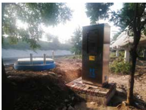
锦州常屯河泵站 日处理量：2400m 3 /D 泵站规格：DN2000*4600
